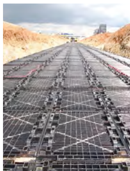
Ouvrages enterrés ou techniques : Box plastique de stockage enterré.
